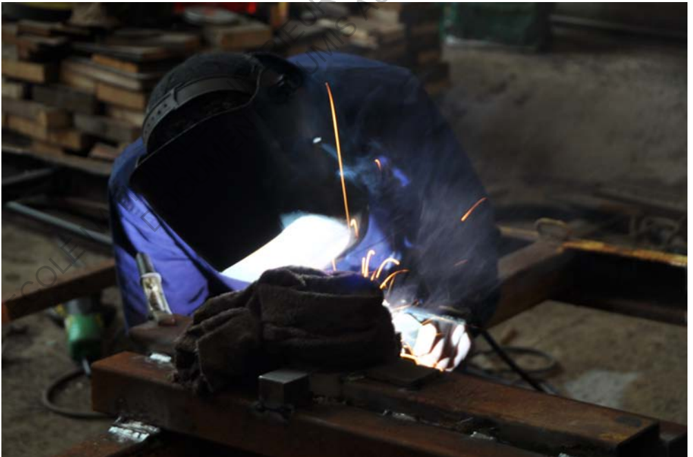
Soudure sur l'essieu directionnel, dans le hangar du chantier de l'Esclain, Nantes.
